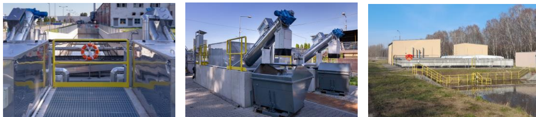
Oczyszczalnia wód opadowych i roztopowych w zakładzie Woodeco Wieruszów i Woodeco Grajewo.
